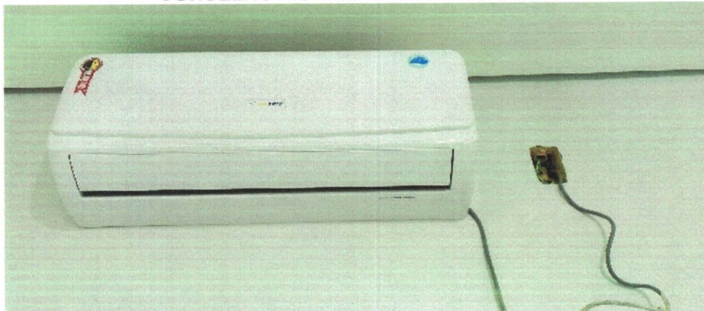
Foto de uma central de ar instalada sem o plug do chicote.
