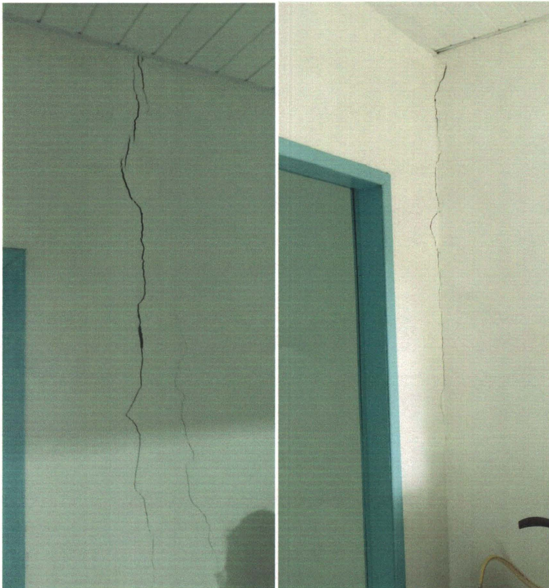
Foto de parede com rachaduras.
