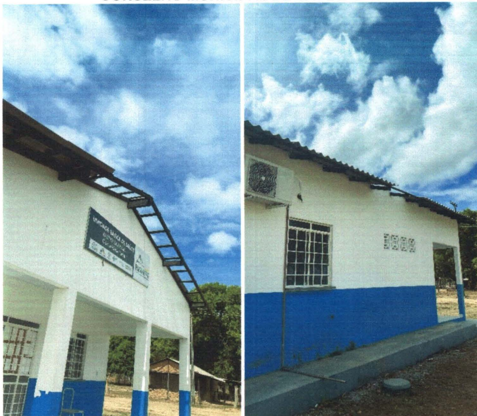
Foto esq. Parte da frente sem algumas telhas que o temporal sacou. Foto dir. Parte lateral da UBS sem algumas telhas.
